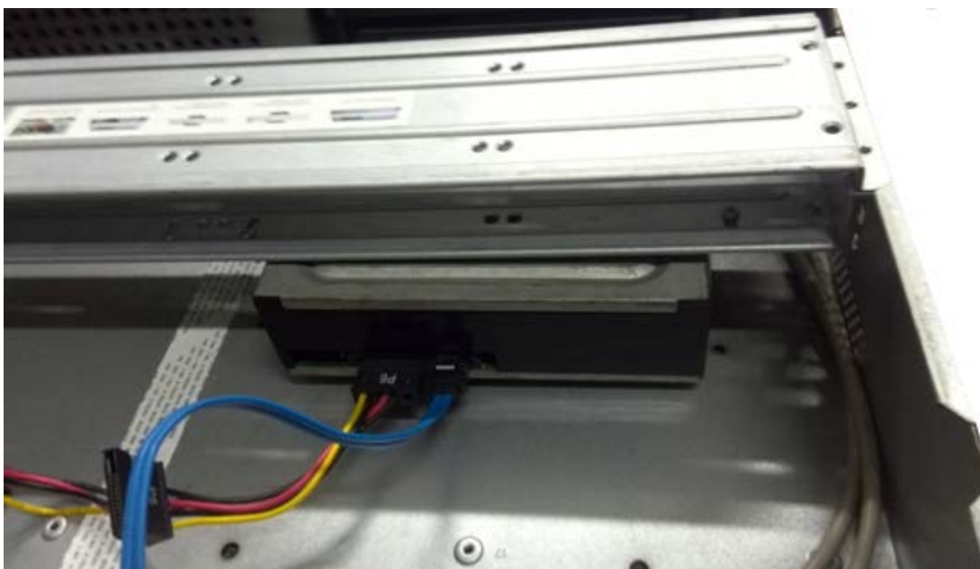
Figura 3-41 Cables de conexión
